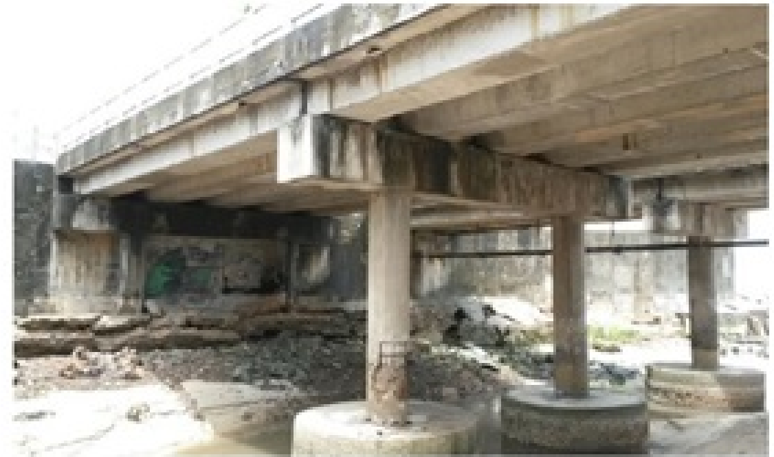
“ESTUDO TEÓRICO DO PROCESSO CORROSIVO DA PONTE SOBRE O RIO CALHAU NA AVENIDA LITORÂNEA” - https://www.abq.org.br/cbq/2014/trabalhos/5/4940-16756.html
